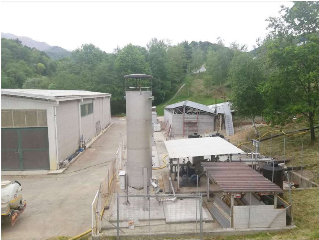
Figura 5: Impianto di estrazione e combustione biogas
