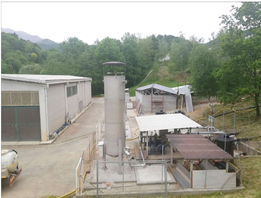
Figura 6: Impianto di estrazione e combustione biogas
