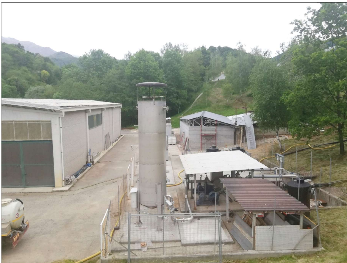
Figura 6: Impianto di estrazione e combustione biogas
